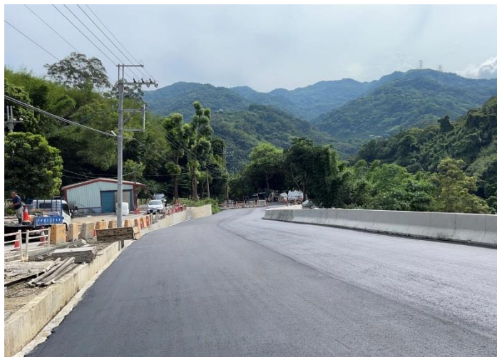
圖 2.25 三峽區北 113 縣(0K+650)災害復建工程
